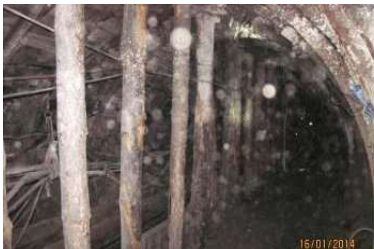
Рисунок 3 - Состояние конвейерного ходка после подрывки пород почвы до подхода лавы
